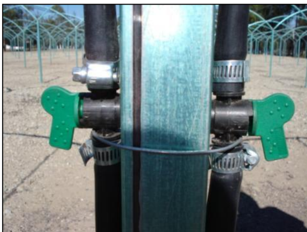
Red de distribución con válvulas
